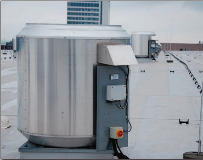
Entrauchungsdachventilator mit der Vorbereitung zur zustandsabhängigen Wartung. Der Messkoffer zur Aufnahme der Daten wird an die Steckkupplung angeschlossen.
