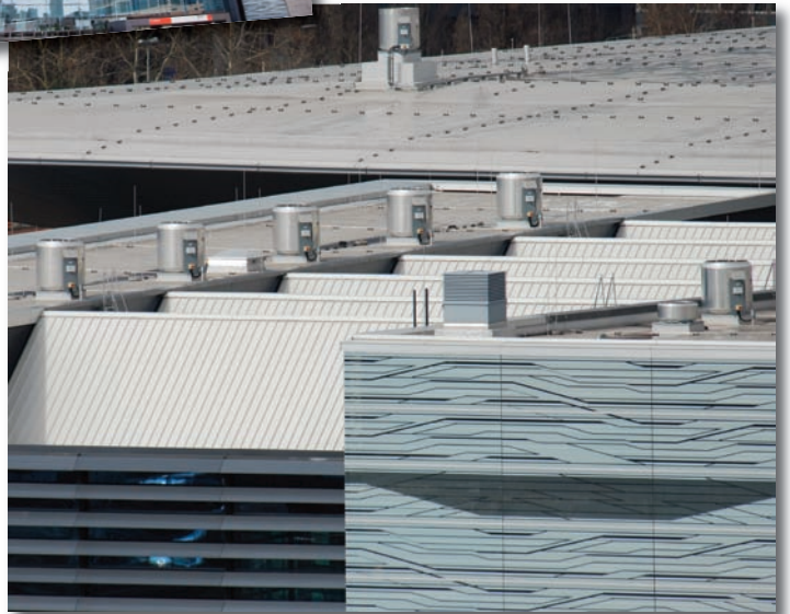
Im Vordergrund ist die Entlastungshaube der Firma Eichelberger zu erkennen. Im Hintergrund die TLT-Turbo Entrauchungsventilatoren.
